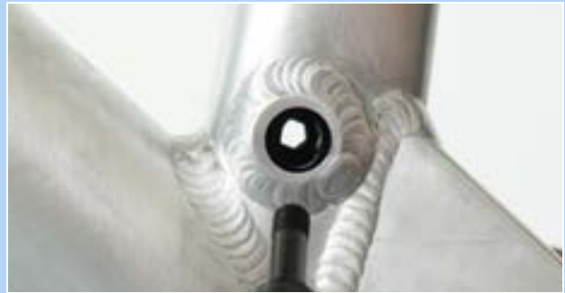
Rysunek 217: Otwór w miejscu styku sworznia
