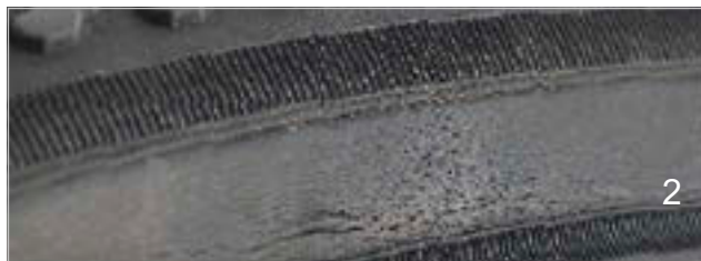
Slika 50: Primeri razpok zaradi utrujenosti (1) in razpok zaradi staranja (2)
